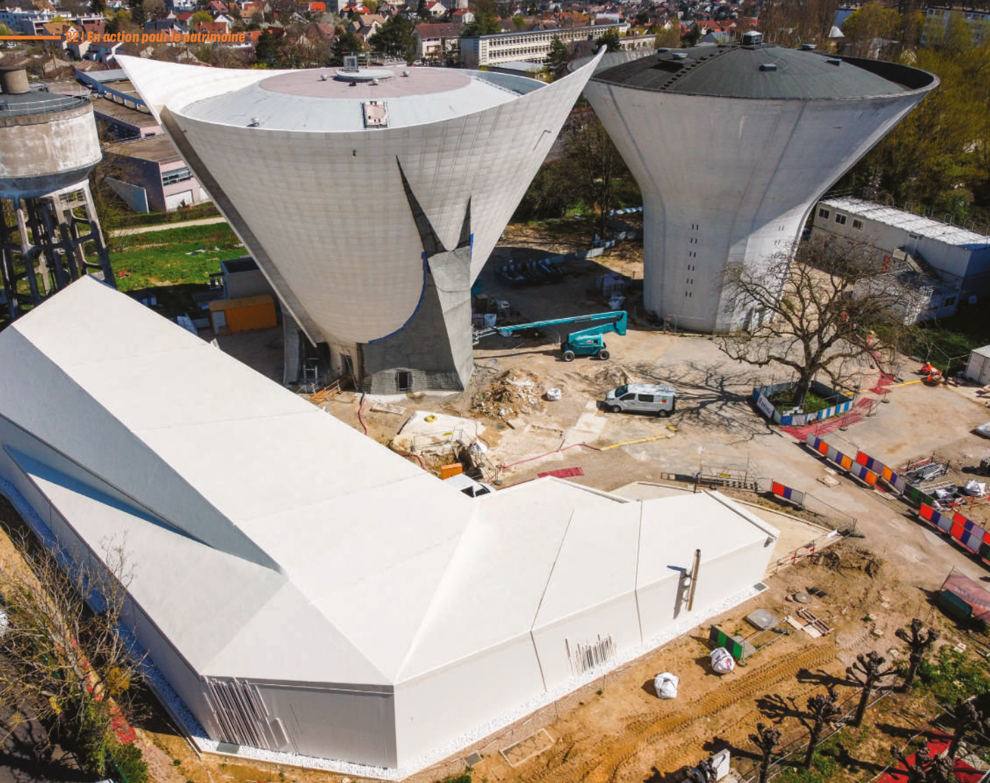
Création d'un nouveau réservoir et rénovation de la station de pompe de Palaiseau
